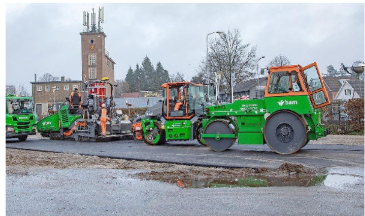
Afbeelding 11: Elektrisch bouwmaterieel (bron: BAM 2023 ).
